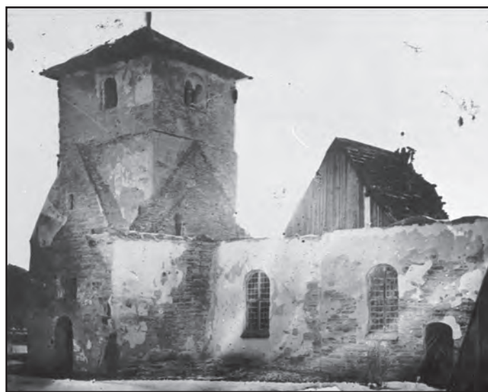
Sörling, Olof. Dala gamla kyrka under rivningen. På bilden är taket på långhuset rivet, till höger syns det Ribbingska gravkoret. Fotograf 1877.
